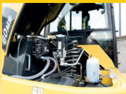
Acesso para manutenção facilitado
